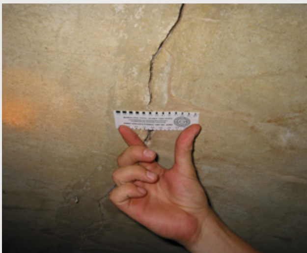
Bild 5: Längsriss im Ortbetonkanal, Quelle: S&P Consult GmbH
