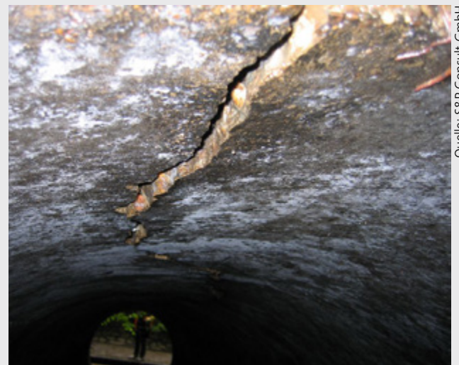
Bild 6: Breiter Längsriss im Scheitel eines Ortbetonkanals
